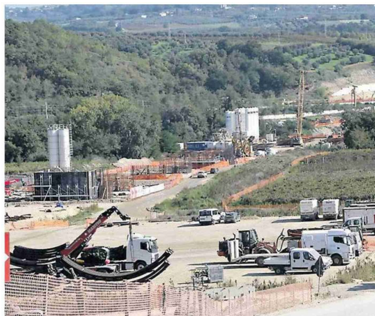
SCAVI Uno dei cantieri dell'Alta Velocità lungo la tratta tra Napoli e Bari nel territorio tra l'Irpinia e il Sannio. L'investimento è di oltre 6 miliardi di euro interamente finanziati. Il completamento dell'opera è atteso per il 2029
